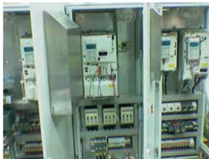
Fig. 2. Vedere dulapuri echipament AER Pod cu Graifăr.
